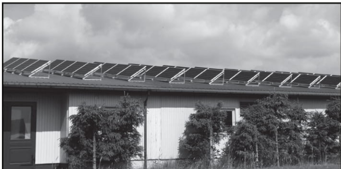
Instalacja o mocy 10 kW na zakładzie stolarskim Ryszarda Grzesieckiego
