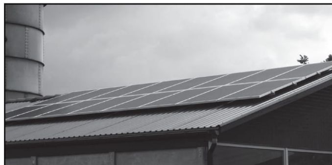
Instalacja fotowoltaiczna o mocy 6,72 kW zasilająca dom państwa Grzesieckich
